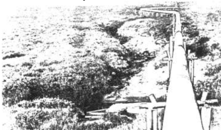
Рис. 1. Термоэрозия и оврагообразование в полосе газопровода из-за использования тяжелой техники. Протаивание вокруг металлических свай и потеря их работоспособности
