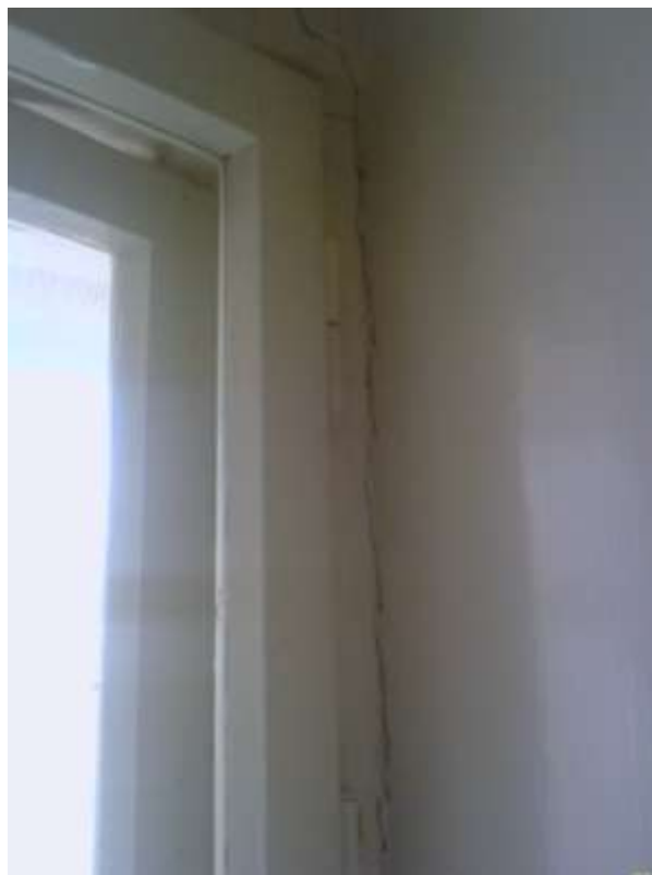
Рисунок 2. Образование трещин в результате землетрясения 24.03.2009.
